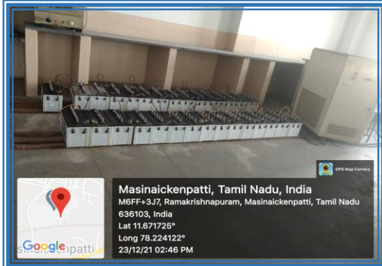
Numeric 30 KVA UPS
