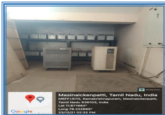
Numeric 10 KVA UPS
