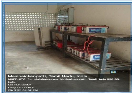
Numeric 15 KVA UPS
