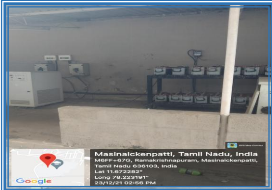
Numeric 25 KVA UPS
