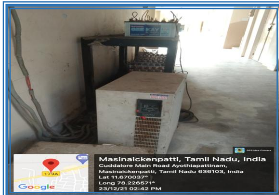
Numeric 10 KVA UPS
