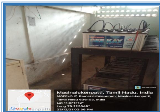
Numeric 10 KVA UPS
